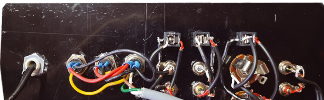
→ Fig. 4 Interno del pannello posteriore di mixer e alimentatore generale.
