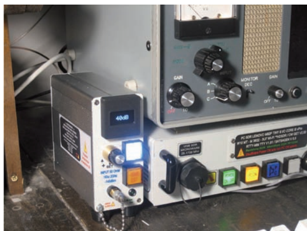
Attenuatore installato a fianco del PC di stazione.
