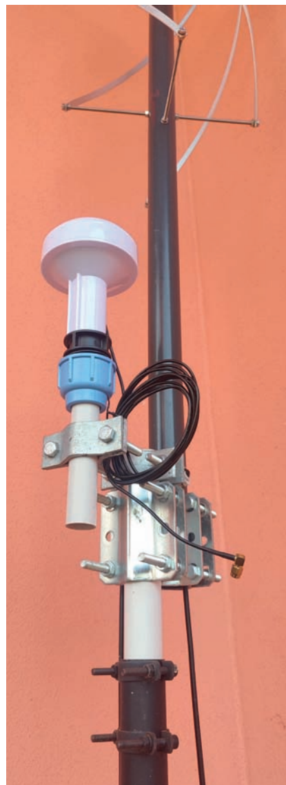
Foto 11 - Antenna su palo
