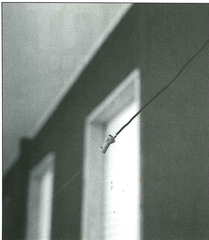
Foto 2 - Isolatore con arrivo cavo dipolo + tirante nylon
