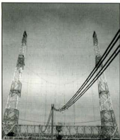
Fig. 5 - Centro trasmettitore di S. Maria di Galeria: l'antenna rotante per onde corte installata nel 1988 con la sua linea di alimentazione a Radio Frequenza.
