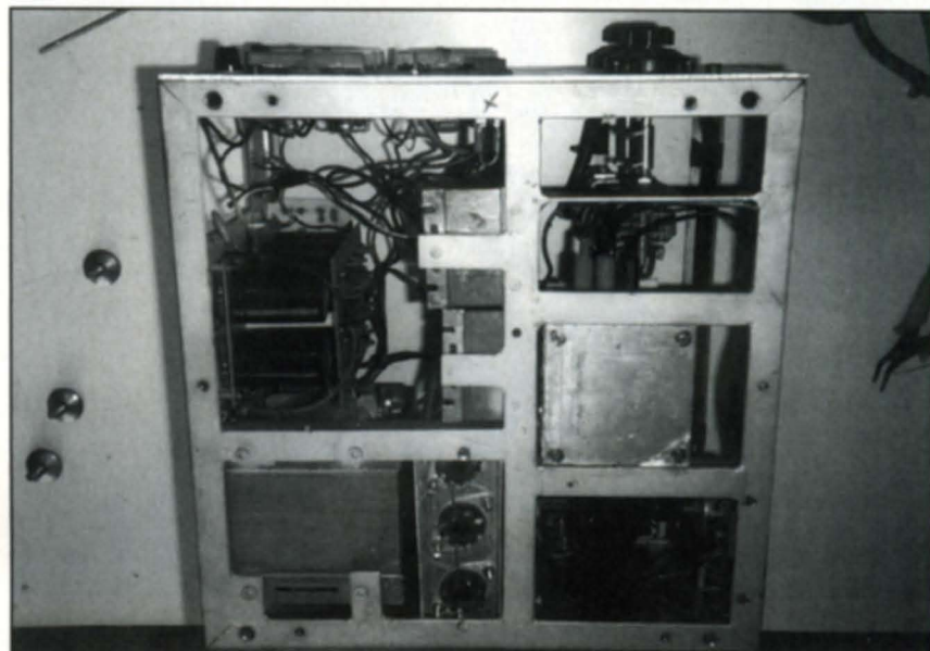
Vista dal basso: a sinistra i circuiti di alimentazione ed ausiliari con relativi trasformatore, gli zoccoli delle stabilizzatrici di VG2 ed a destra la parte radio-frequenza.
