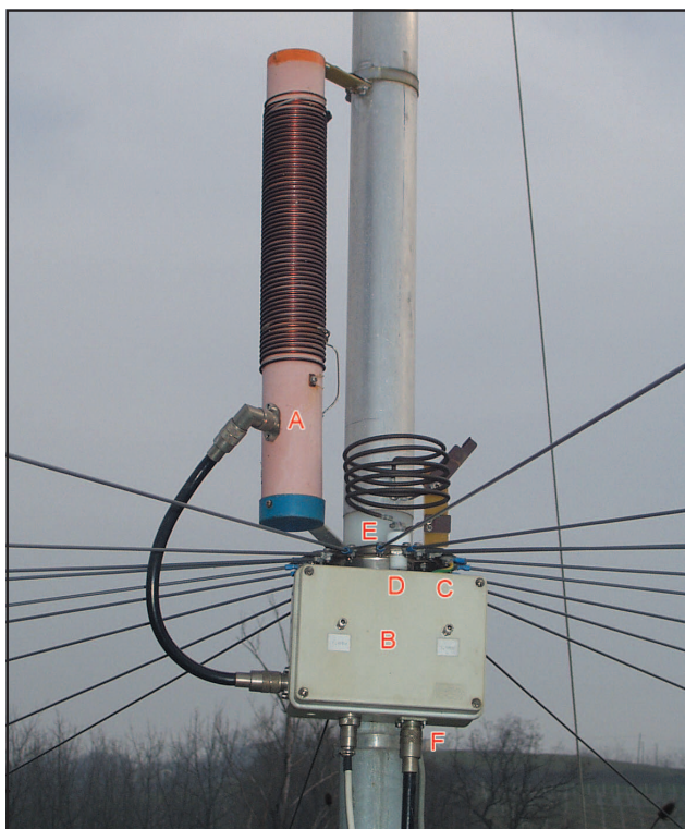
Foto 1 - A = Alim. banda 160, B = Scatola relè, C = Collegamento piani di terra, D = Connessione 80 m (lunghezza limitata), E = Passante isolato, F = Cavo coax al TX
