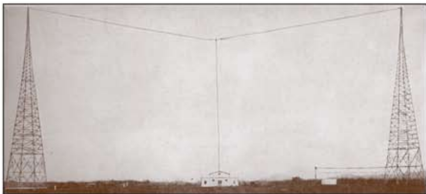
Sistema d'antenna della stazione KNX.
