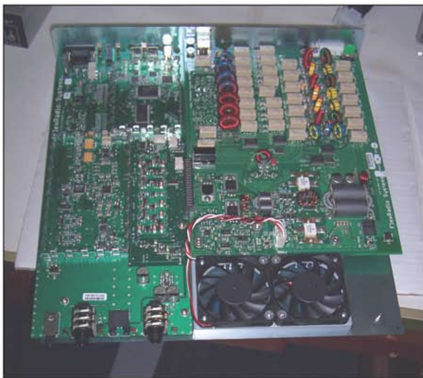
Foto interno FLEX 3000 a destra unità di potenza, accordatore e filtri di uscita; a sinistra ricevitore con front-end, mixers, DDS e resto dei componenti
