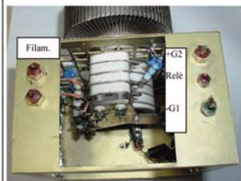
Vista scatola pressurizzata dal lato ventilazione e da sopra con valvola montata. Notare il particolare dell'innesto a baionetta dello zoccolo con relativi separatori ceramici. Frontalmente le uscite con condensatori passanti delle alimentazioni. Sono ben visibili le due treccie di rame che vanno al filamento
