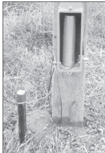
Foto 1 - Base di un elemento verticale; scatola che contiene anche bobinetta, resistore, connettore e morsetto delle terre e puntazza inserita.
