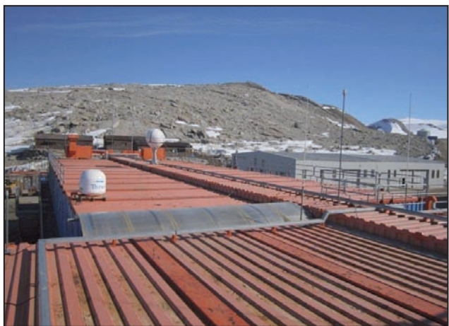
Antenne del sistema satellitare presenti sul tetto della base
