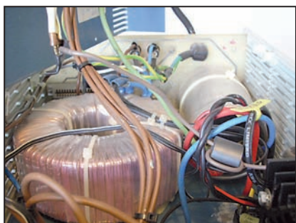
Vista del trasformatore toroidale.
