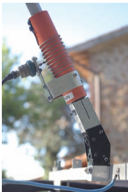
La base dell'antenna dei 40 m con l'attacco alla traversa, il filo di massa e l'autotrasformatore: notare la presa a circa metà dell'autotrasformatore, diversa da quella degli 80 e dell'altra frequenza.
