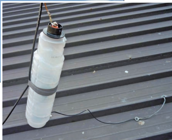
Foto 4 - Collegamento calza al contrappeso - tetto metallico. Notare il condensatore in serie al collegamento che è opportunamente protetto entro un contenitore in PVC
