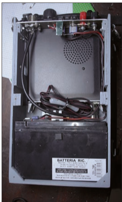
Disposizione interna della batteria e dell'apparato
