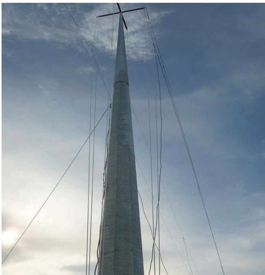
Fig. 4 - Il palo autoportante di circa 24 m ove sono il loop dei 160m e quello dei 630m
