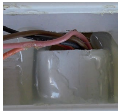
Fig. 8 - Il loop bloccato sul tubo di sostegno
