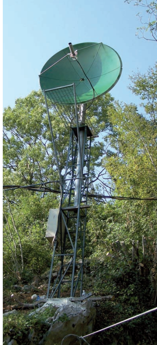
Nuovo traliccio con parabola da 1,8 metri.
