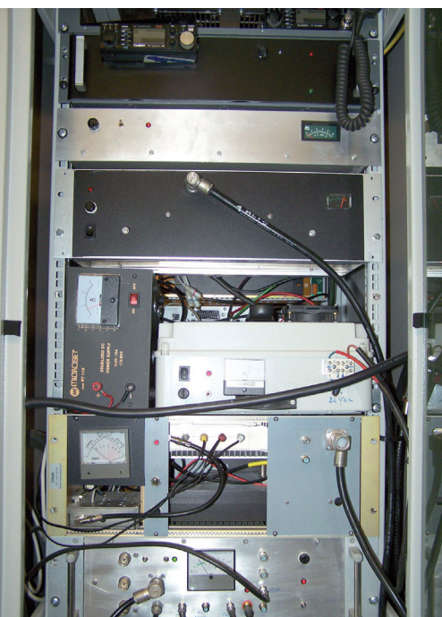
L'interno di uno dei rack
