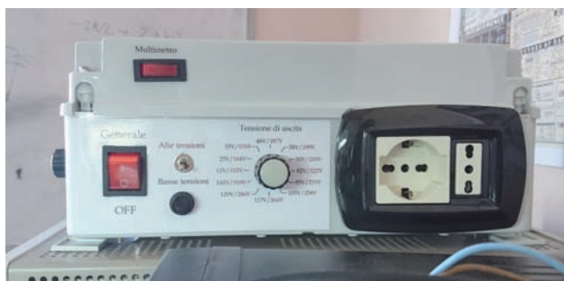
Foto 2 - Controllo della tensione di uscita del TrasformaTorino
