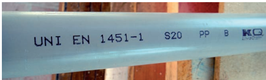
Fig. 2 - Dettaglio della tubazione impiegata come supporto
