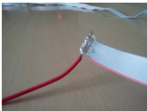
Estremità del loop verso il trasformatore.
