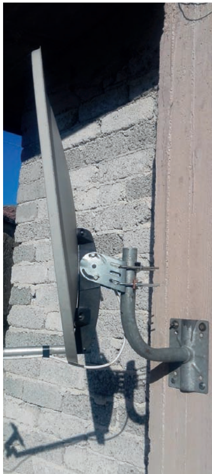
Fig. 15 - La parabola a puntamento eseguito.
