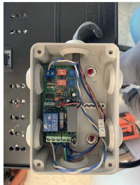
Foto 3 - Il temporizzatore installato e cablato
