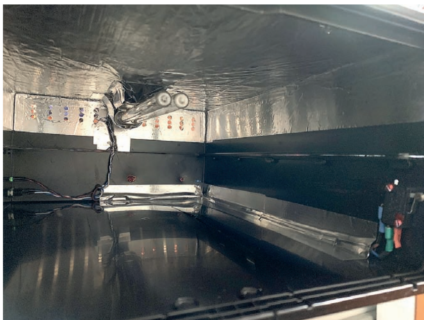
Foto 4 - La camera cablata con il microswitch di sicurezza in primo piano
