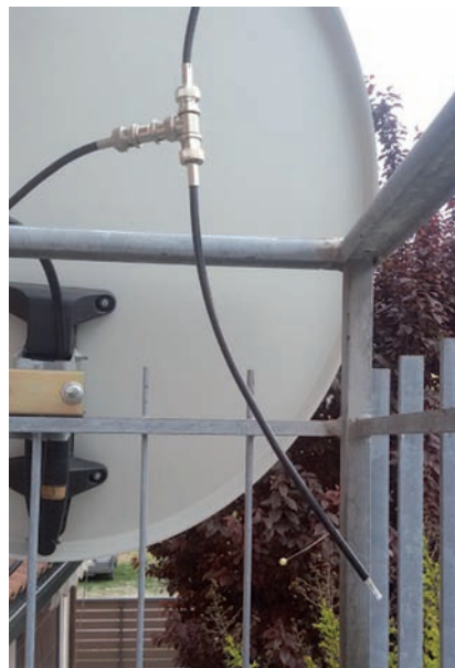
Foto 1 - Particolare del "T" e dello STUB con spillo di taratura.
