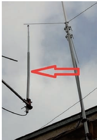
Fig. 1 - L'antenna omnidirezionale verticale installata.
