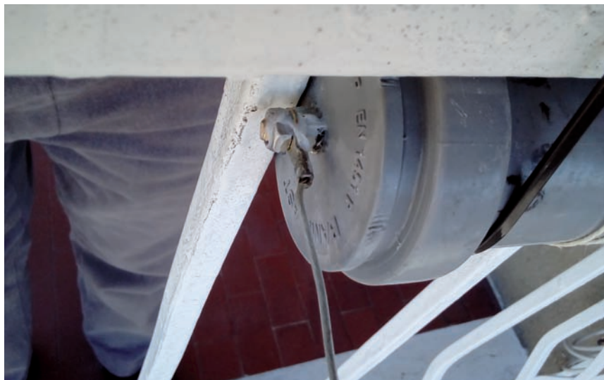
Vista lato uscita antenna
