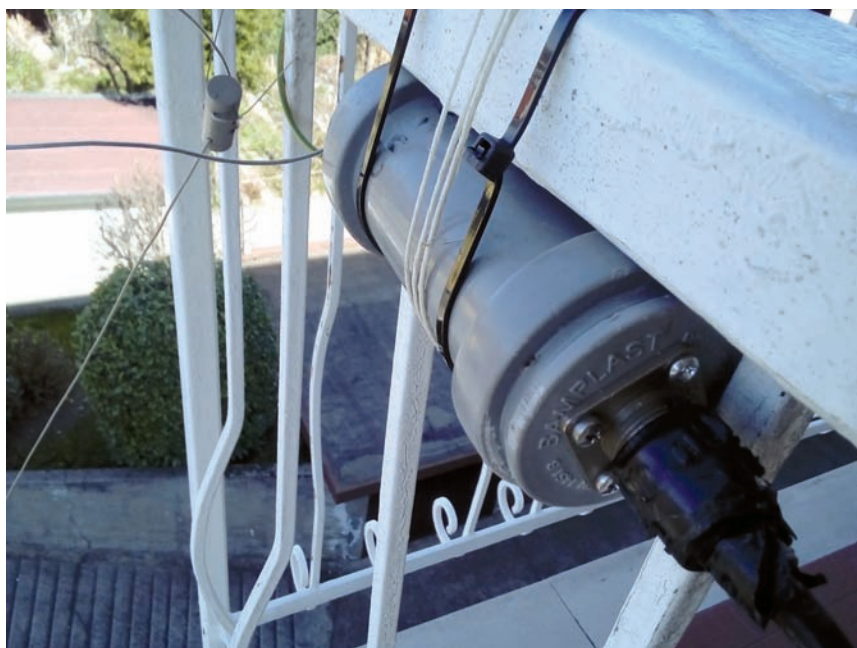
Vista lato alimentazione
