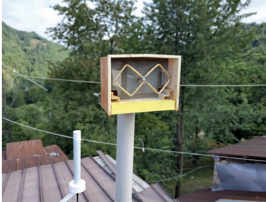
Antenna montata sul tetto
