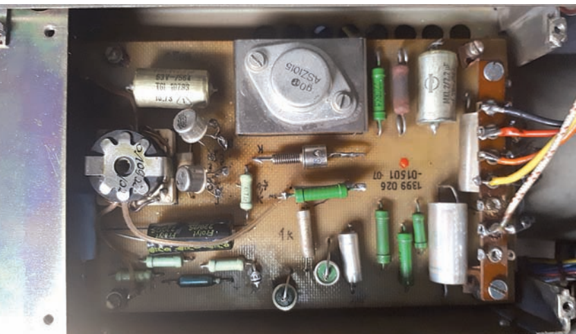
Piastra originale. Sulla sinistra il trasformatore incriminato. Notare la striscia a saldatura aggiunta per l'uscita dei fili verso il nuovo alimentatore
