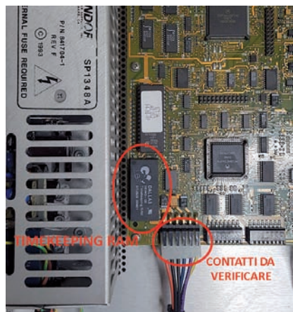
Figura 7 - Ubicazione dell'integrato Timekeeping in un WJ-8711A di ultima generazione. Si noti anche il connettore di alimentazione, talora fonte di problemi
