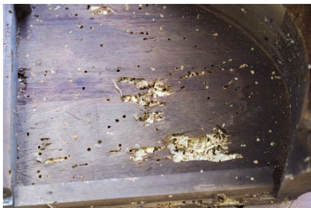
Figura 4 - Stato interno del mobile della radio: sono visibili gli ingenti danni da parassiti che hanno eroso gran parte della struttura lignea del mobile
