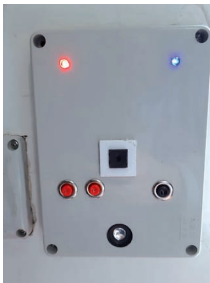
Il dispositivo installato
