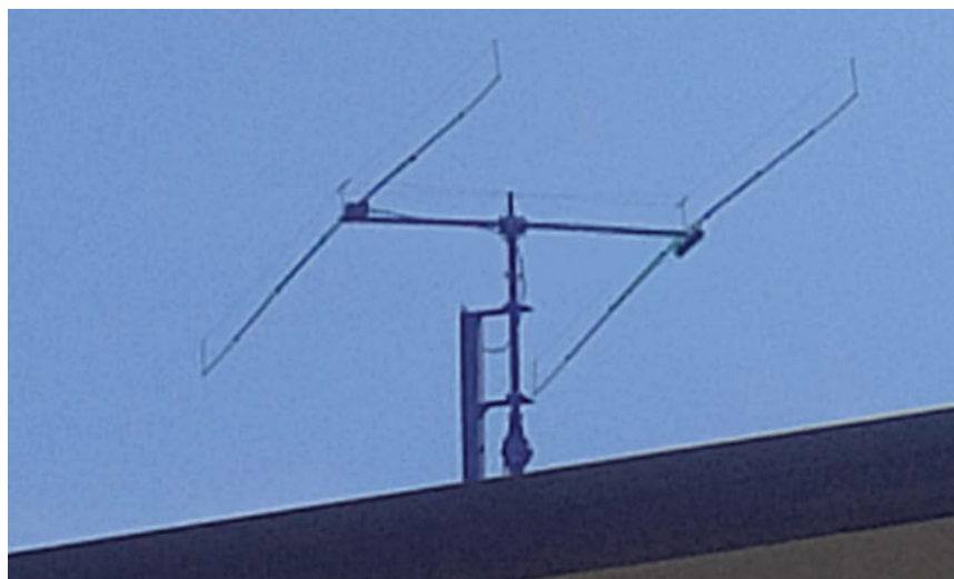
D2T sul tetto di Piero IK2SHQ
