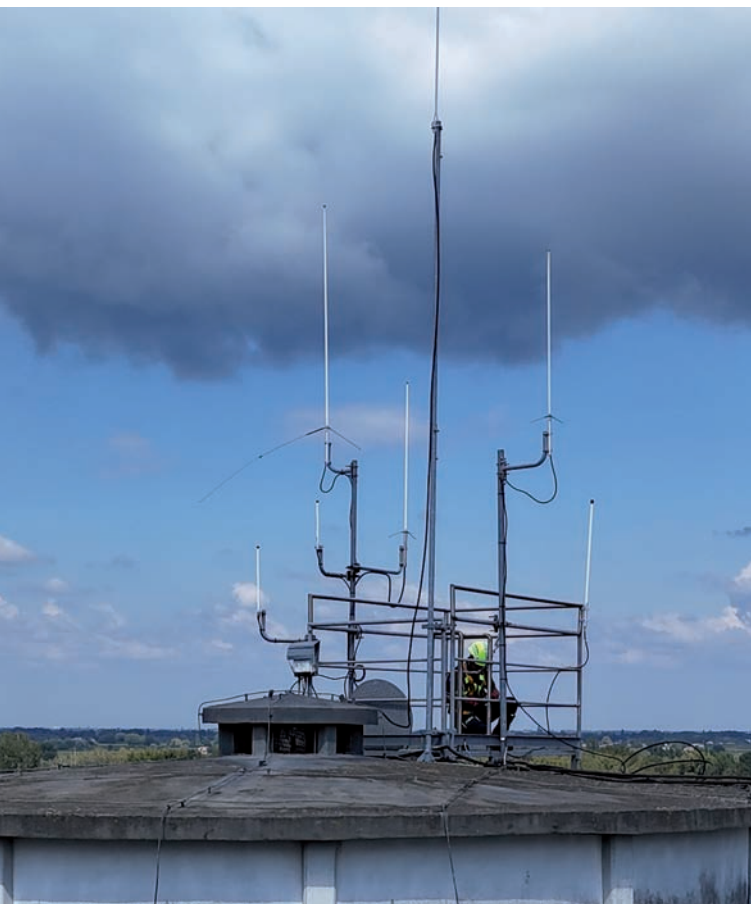
Fig. 1 - Installazione di una nostra antenna sulla torre idrica di Bagnacavallo (RA), durante l'alluvione che ha devastato Traversara di Bagnacavallo nel settembre del 2024.
