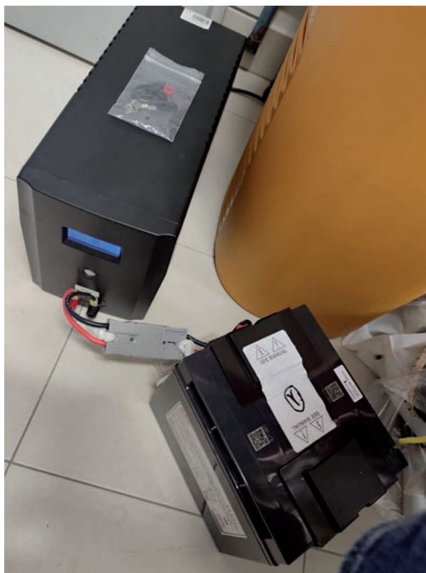
Foto 2 - Batteria 24V collegata
