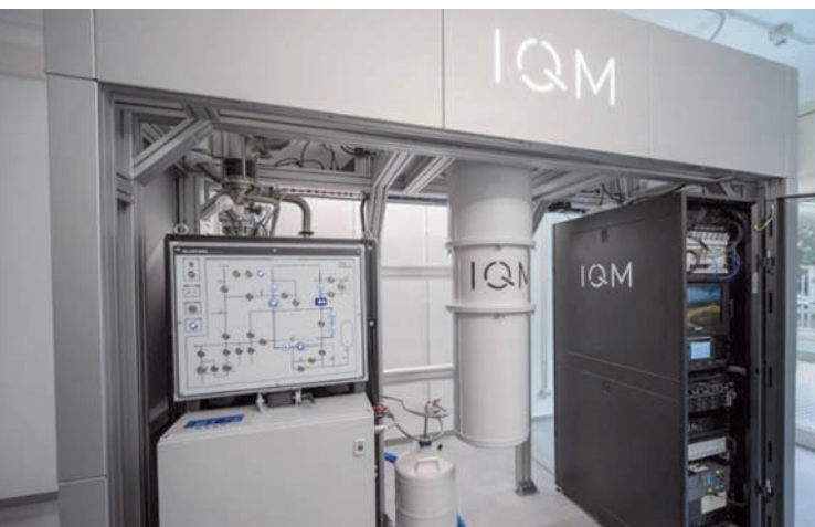
Foto A - Computer quantistico IQM a 5 qbit (Data Center del Politecnico di Torino)
