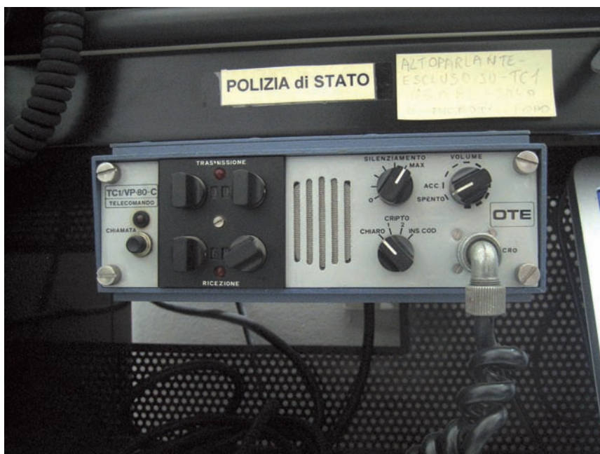
Fig. 4 - Apparato radio della Polizia di Stato presente nella sala radio della prefettura di Milano nel 2012 insieme a quelli degli altri organi di P.S., enti di soccorso e aziende gestrici di servizi essenziali come acqua potabile ed elettricità
