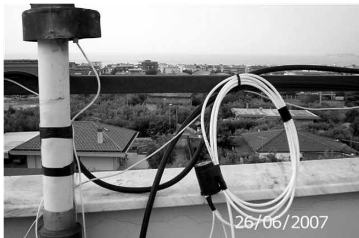
Particolare del balun a coke e punto di alimentazione.
