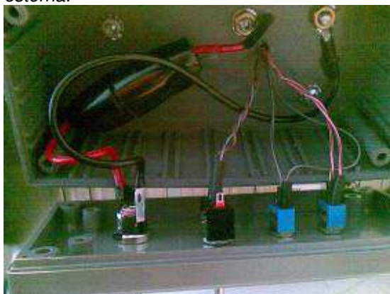
Interno della scatola Teko: a sinistra la presa alimentazione; a lato i tre deviatori.
